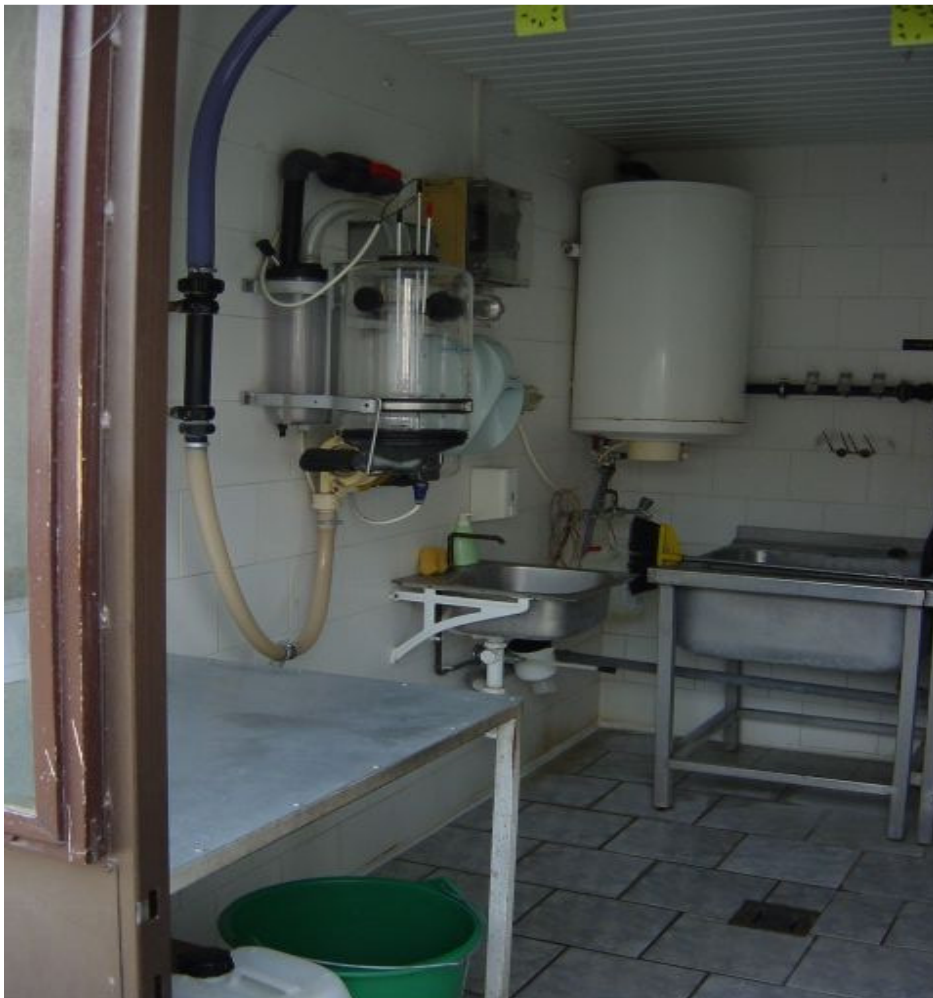
8. kép: A tehenészet tejkezelőjének részlete. A baloldali falra szerelték a tejvezetékes fejőberendezés tejléválasztóját, ahonnan eljut a tej az 1200 literes hűtőtárolóba. Szemben a mosogató felszerelés látható.
